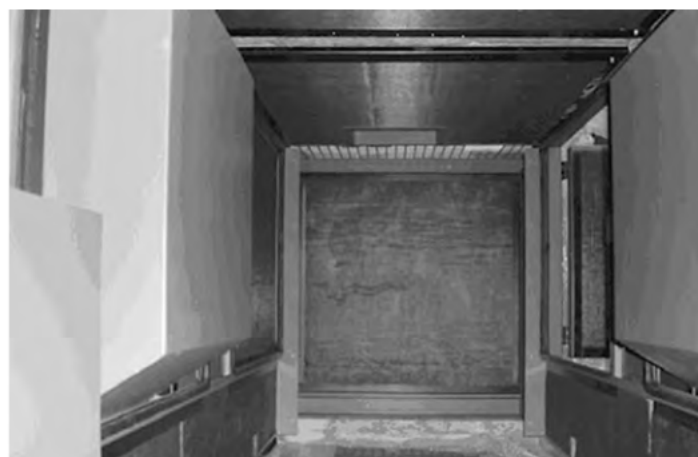
Imagen 3 - INTERIOR DE UN GRUPO ELECTRÓGENO INSONORIZADO
